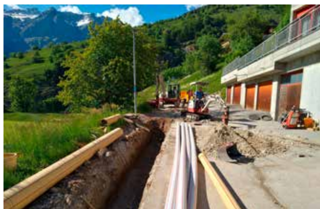
Investitionen in die Infrastruktur: Die Erarbeitung des generellen Entwässerungsplans (GEP) löste als erste Sofortmassnahme 2020 den aufwendigen Bau einer neuen Oberflächenwasserleitung auf der Tschingerestrasse unter dem Dorf aus.
